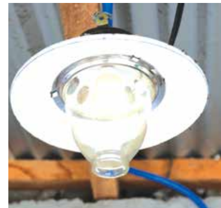
installation alimentée par le biogaz sur la ferme de M. KOUAME Kouassi Augustin éleveurs de porcs à Bouaflé
