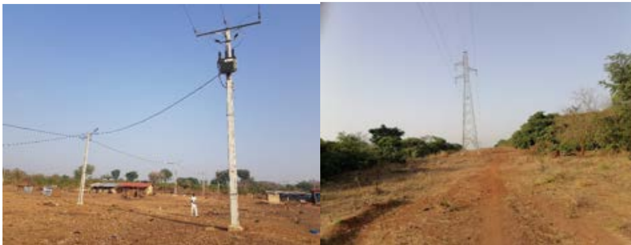
Planche 13 : Vue de la Haute Tension (HT) et du raccordement de Sanankoro à partir de la Moyenne tension
