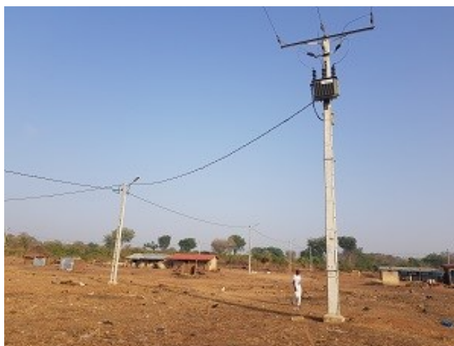
Photo 5 : Vue de l'électrification du village, Source : BRLi-CI, Février, 2021
